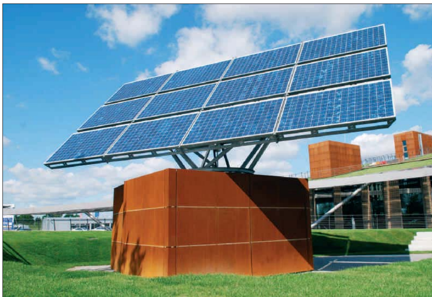
Die Vanadium-Redoxflow-Batterie unter der PV-Anlage speichert bis 100 kWh Sonnenstrom und ermöglicht zu jedem Zeitpunkt bis 10 kW Energieentnahme
